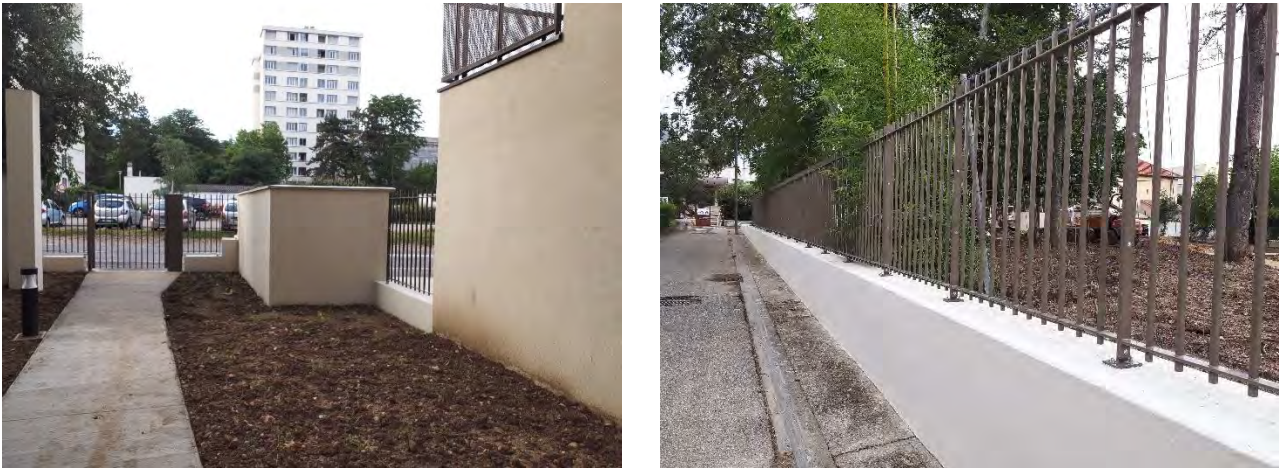
Figure 20 : Enceinte d'une construction récente, avec des barrières perméables à la petite faune, mais montées sur des murets hauts, infranchissables pour une espèce à faible capacité de déplacement comme le hérisson (Biotope, 2021)
